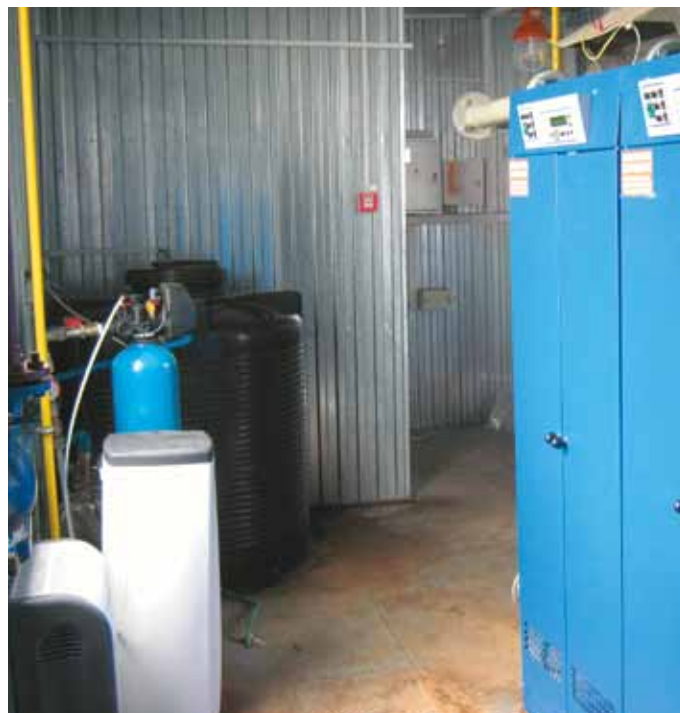
Котельня ТОВ Санаторій Нива
