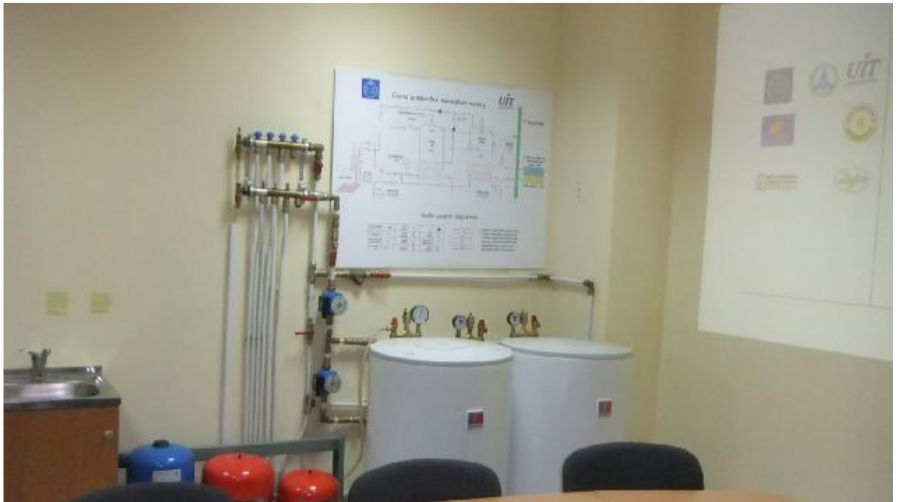
Частина інноваційної системи опалення й гарячого водопостачання, створеної на основі використання тепло насосних технологій
